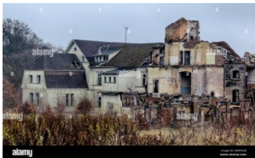
Bild 14 Albrechtshaus - nur noch Ruine
