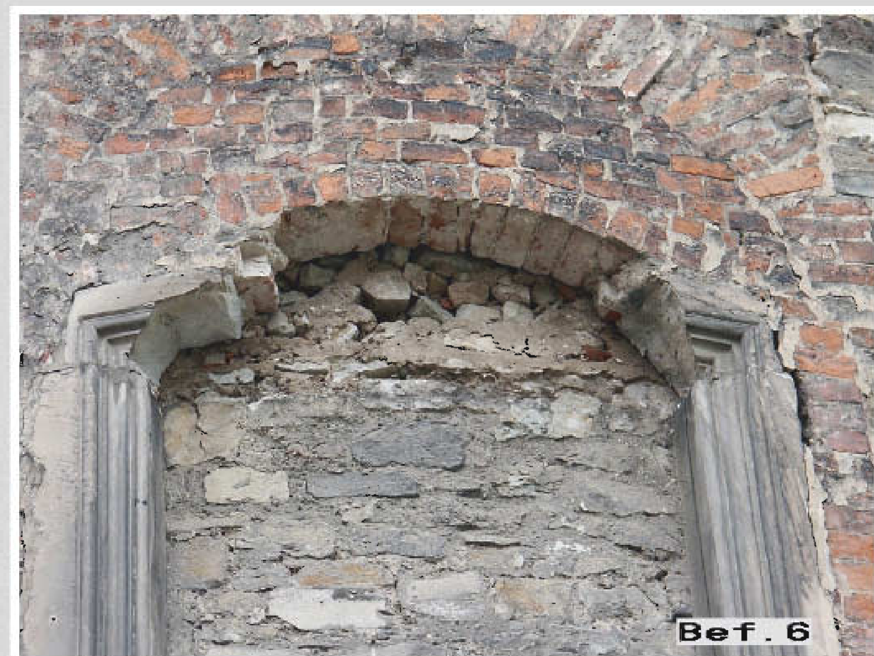
Ausbruch des Fenstersturzes im Scheitel der Kapellenapsis, hervorgerufen durch Drucklast des Überfangbogens und Frostsprengung, DuB 2009.
