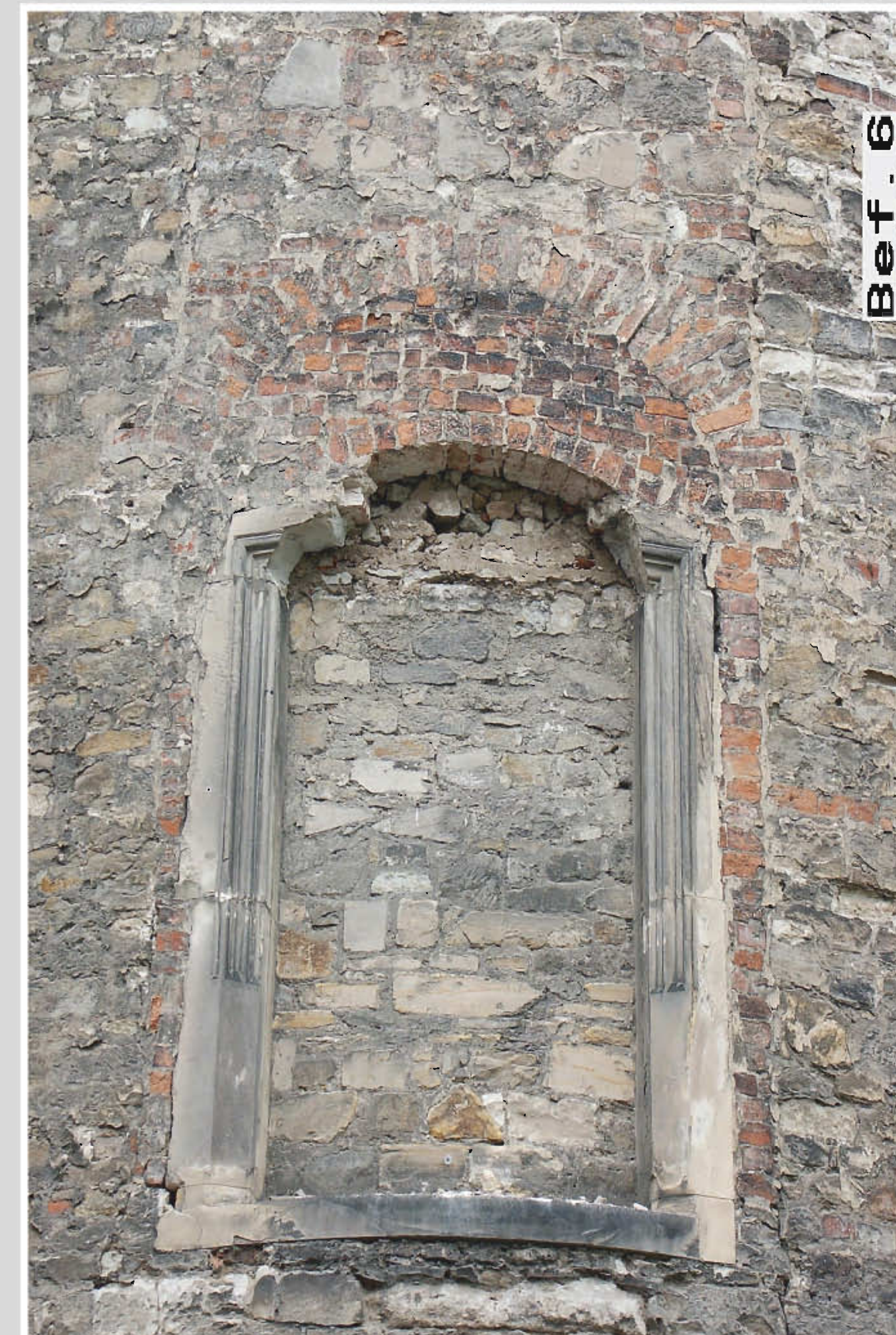
Durch Frostsprengung im Frühjahr 2009 ausgebrochener und abgestürzter Sturz des Scheitelfensters. Das renaissancezeitlich profilierte Gewände und dessen Einbausituation gaben Anlass zu kunstgeschichtlichen Überlegungen hinsichtlich der ursprünglichen Baugestalt und Entwicklung der Kapelle.
