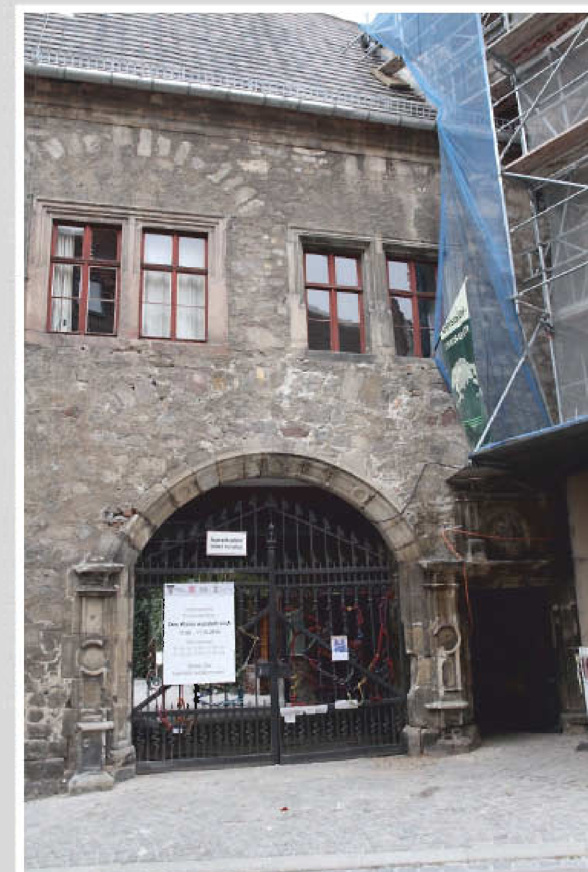
Renaissancezeitliches Tor und Pforte im Ostflügel mit Anschluss an die Kapellenapsis. Die mit Relief verzierten Werksteine der Gewände, des Bogens und des Pfortensturzes sind z.T. stark beschädigt und bereits früher ausgetauscht worden, DuB 2010.
